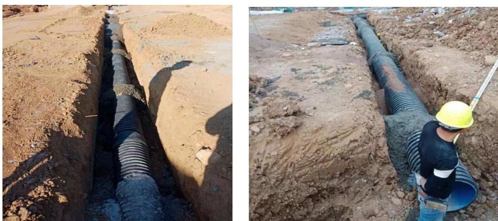
(a) 雨水管网（拍摄时间 2020 年 10 月）
