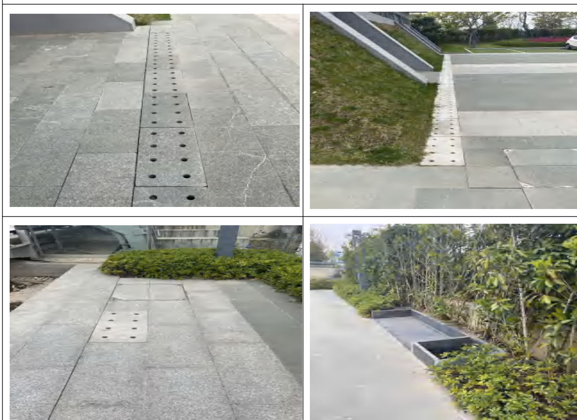
雨排管网照片 2022.8.15
